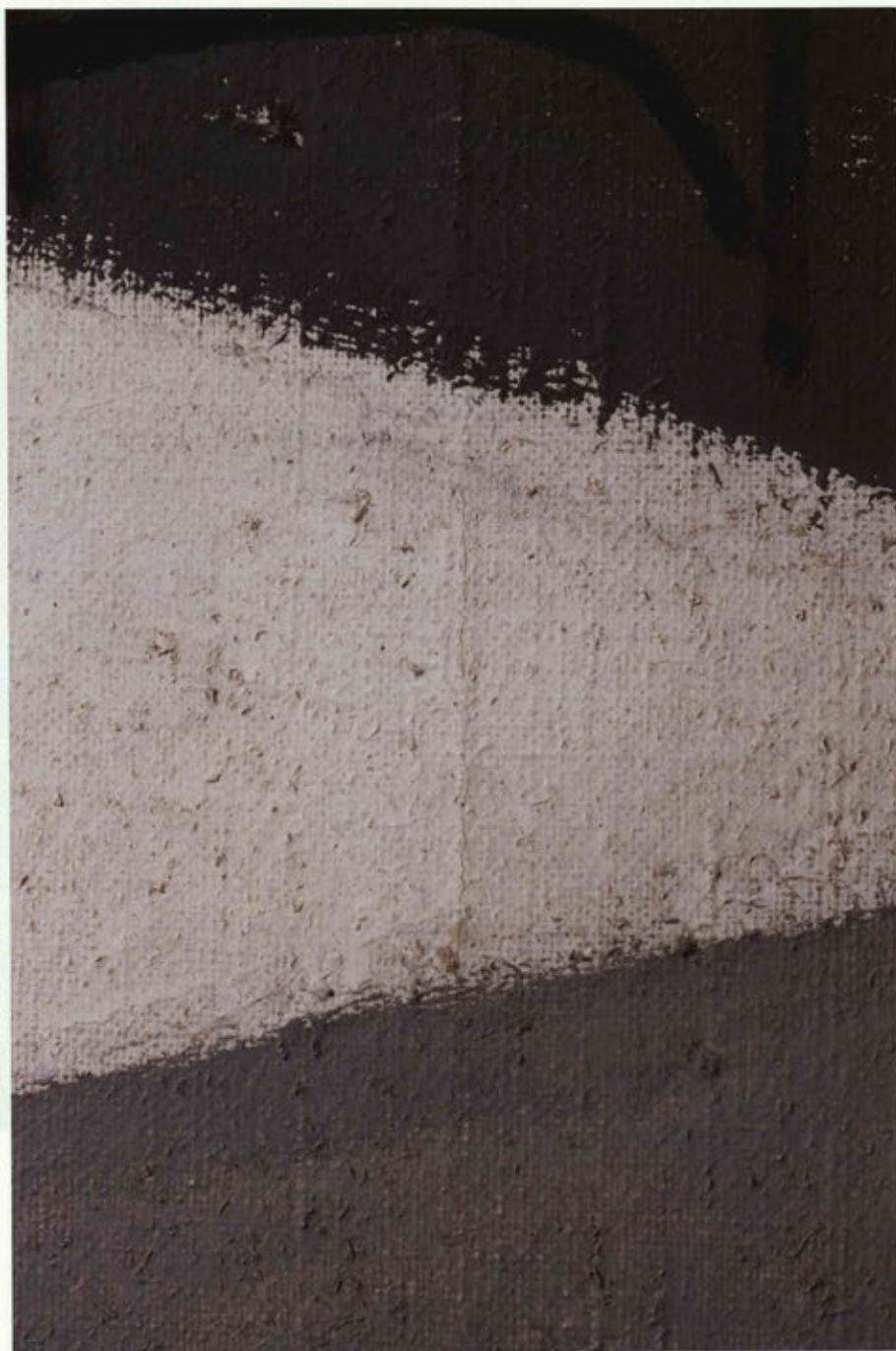
14 (A-9, B-9) Grietas. Suciedad superficial. Pérdidas.
