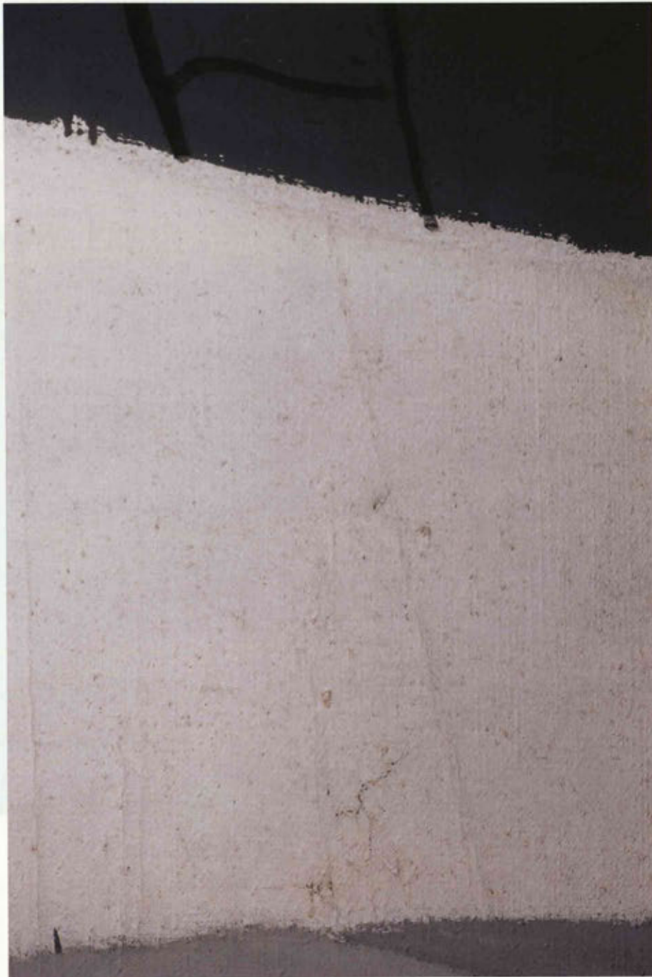
13 (A-8, B-8) Grietas. Suciedad superficial.
