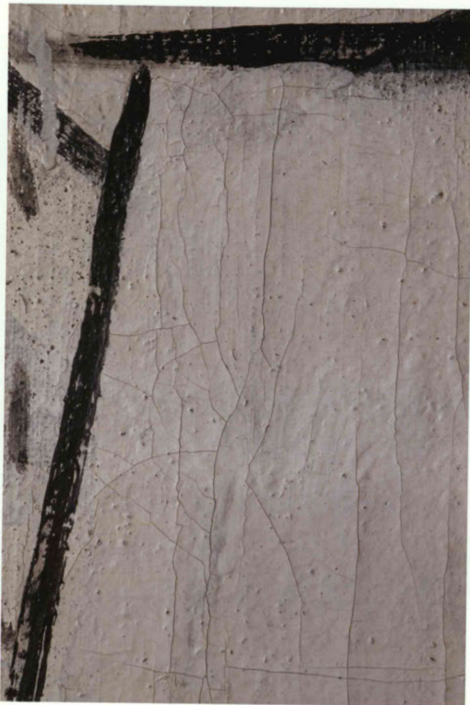
107 (E-8) Grietas verticales y craquelados.
