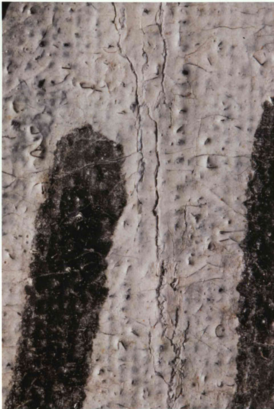
130 (D-5) Grietas. Microfisuras.
