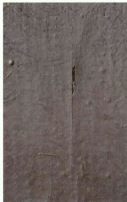
Fot. n.º 124. Estado actual. Detalles de craquelados y pérdidas de capa pictórica y preparación.
