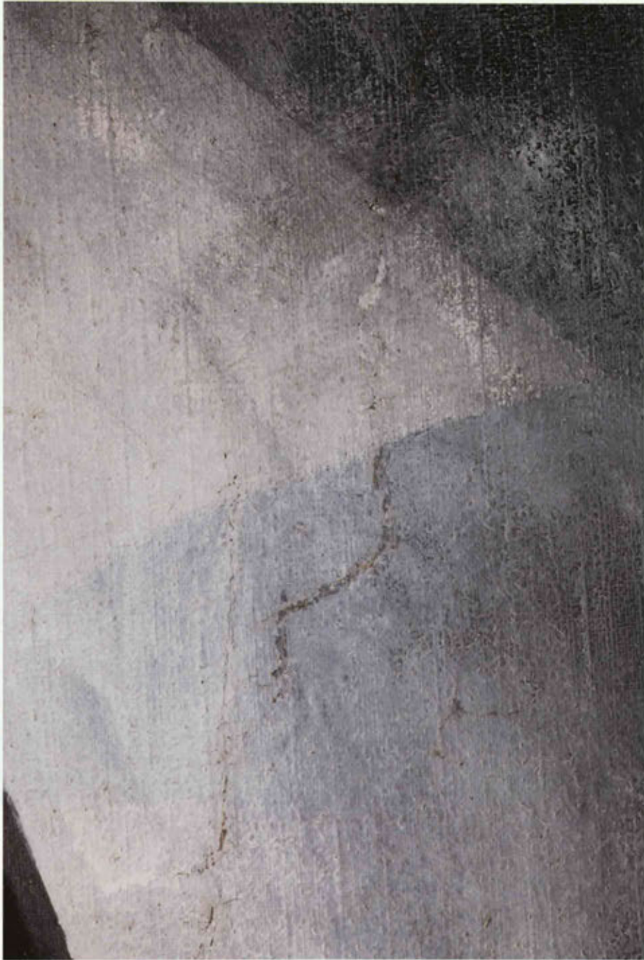
39 (C-7) Grietas. Pérdidas.
