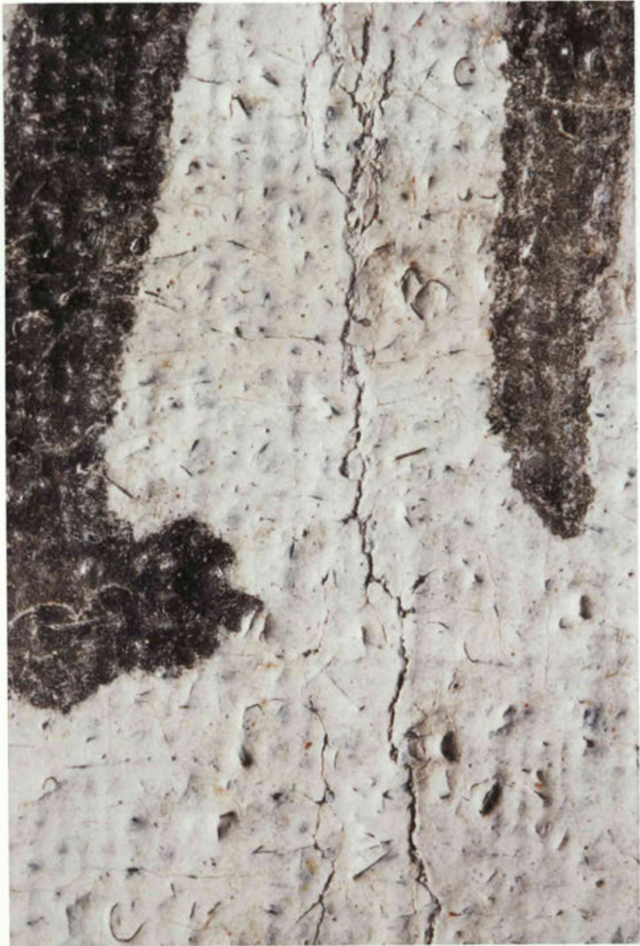
68 (D-5) Grietas. Microfisuras. Suciedad.
