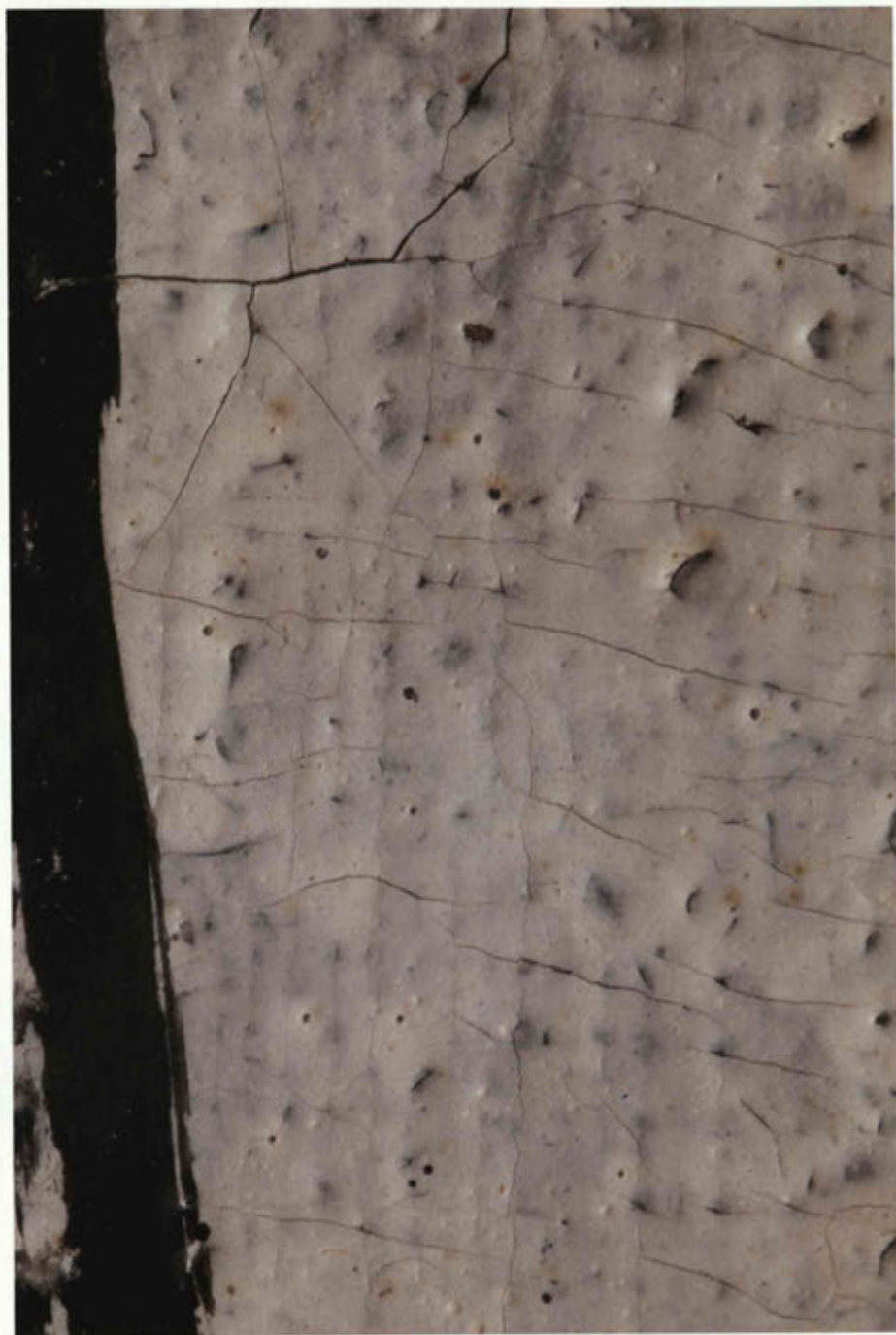
66 (D-5) Grietas. Microfibruras. Suciedad.
