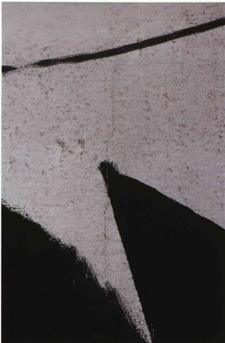
8 (A-6) Grieta (sentido vertical)
