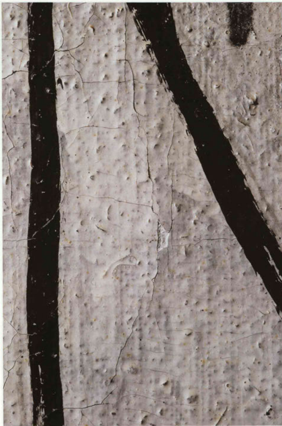
100 (E-4) Grietas con levantamientos y pérdidas. Microfisuras.
