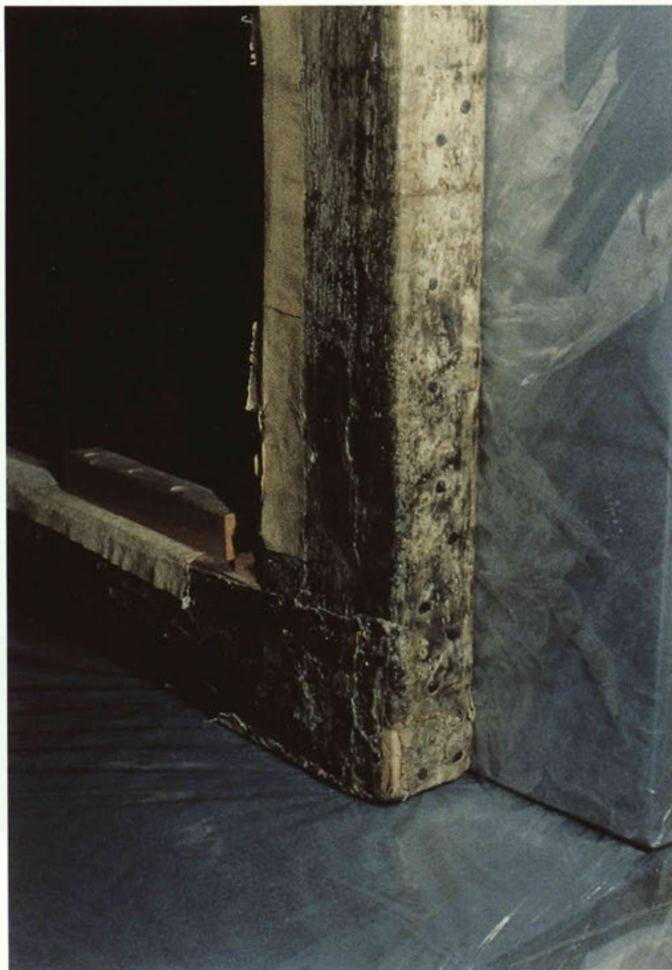
4. Detalle de daños en el soporte.
