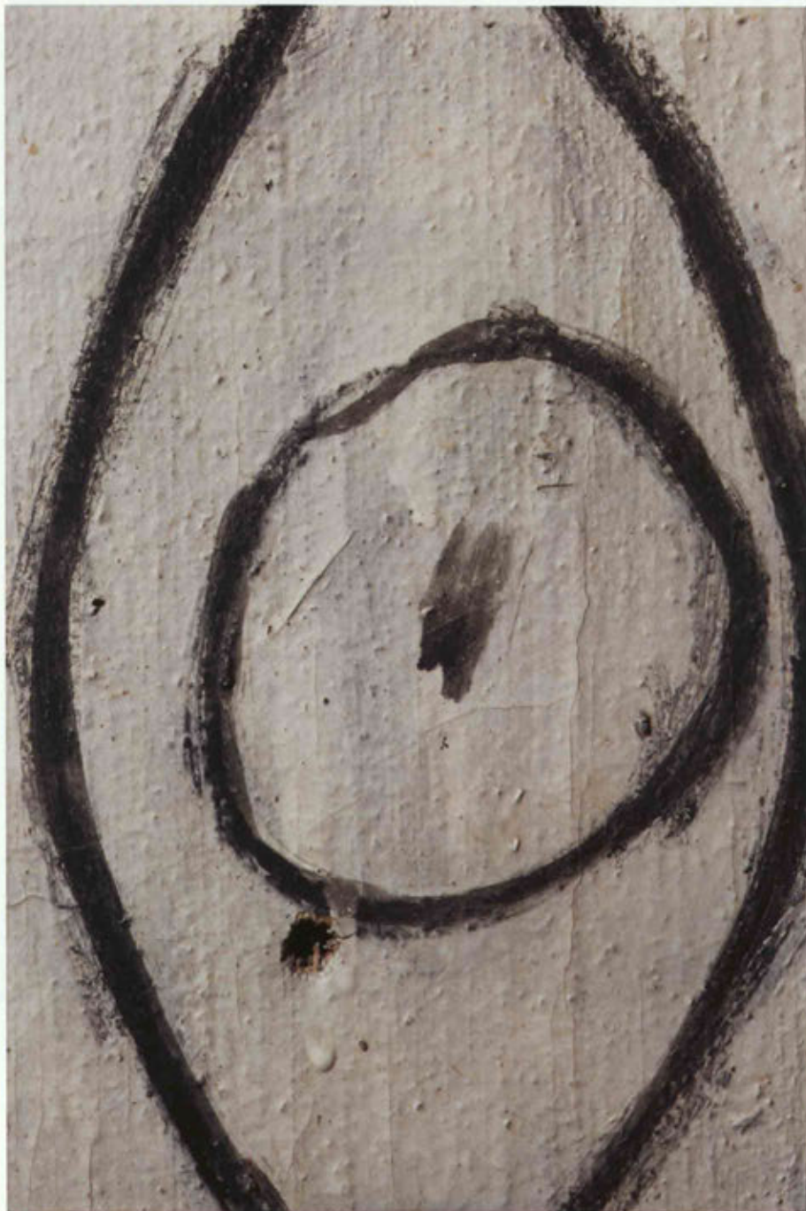
120 (F-3) Orificio con pérdida del soporte. Grietas en sentido vertical.
