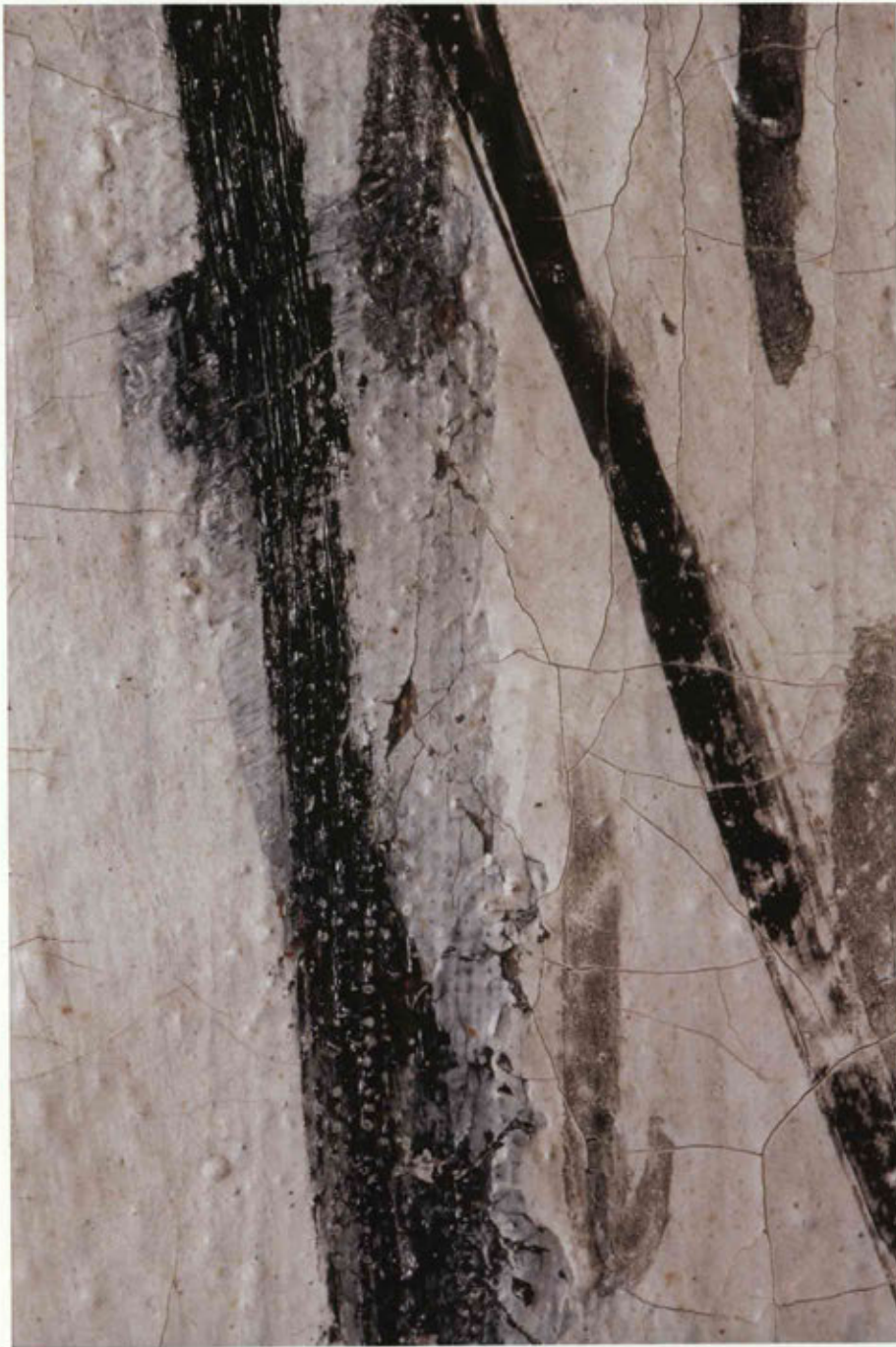
106 (E-7) Grietas verticales, craquelados y pérdidas.
